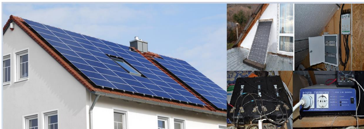
Рис. 4 Маломощные солнечные установки для автоматического потребителя в Крымском регионе (справа 5,4 кВт, слева 500 Вт с аккумуляторной системой и инвертором)
