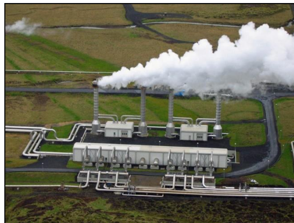
Рис. 2. Геотермальная тепловая электростанция
