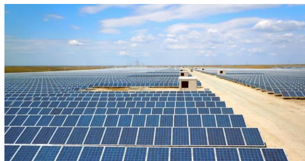
Рис. 1. Солнечная фотоэлектрическая станция
