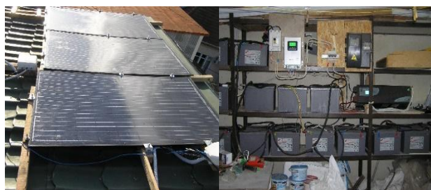
Рис. 3. Автономная малая солнечная электростанция с накопителями энергии мощностью 5400 Вт (г.Алушта)
